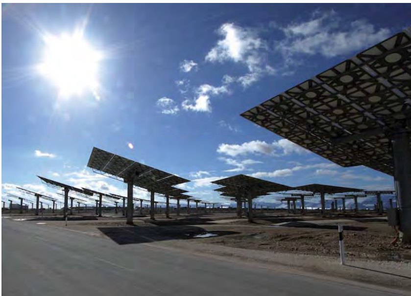
Planta solar termoelectrica Gemasolar en Sevilla (España) / Gemasolar thermosolar power plant in Seville (Spain).
