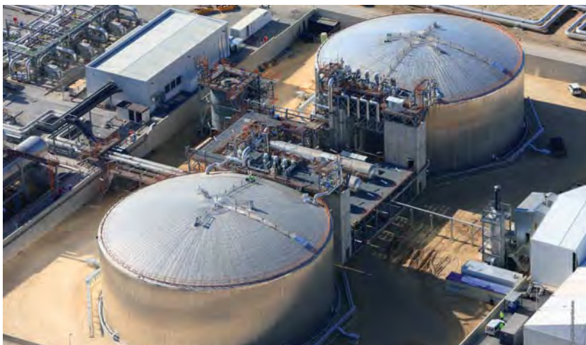
Detalle del sistema de almacenamiento de sales fundidas en plantas termosolares. Detail of molten salt storage system in thermosolar plants.
